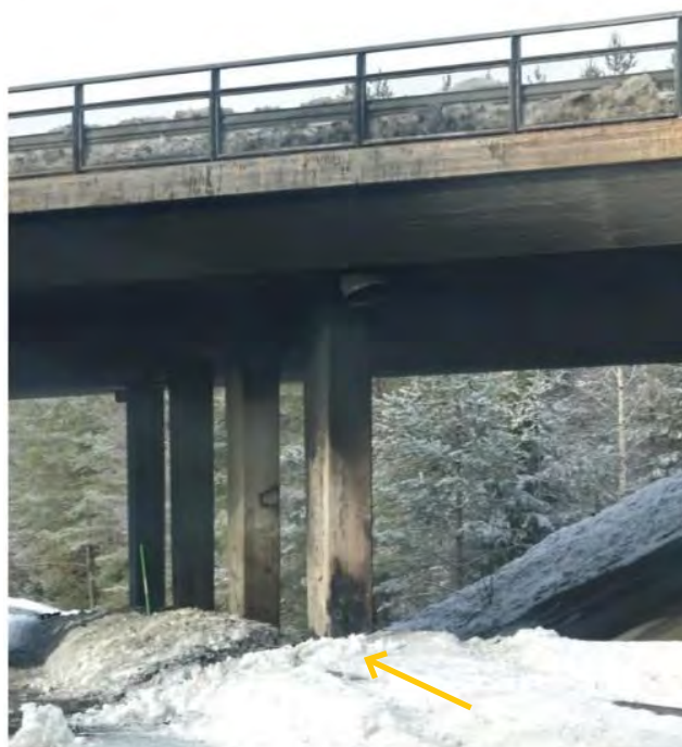
Bild 1. Dödlig krasch mot den sotfärgade bropelaren. Skydds-räcket var uppenbarligen ur funktion på grund av snölagret framför räcket. Platsen var Stöcksjö, E4 strax söder om Umeå – hastighetsgräns 110 km/tim.
