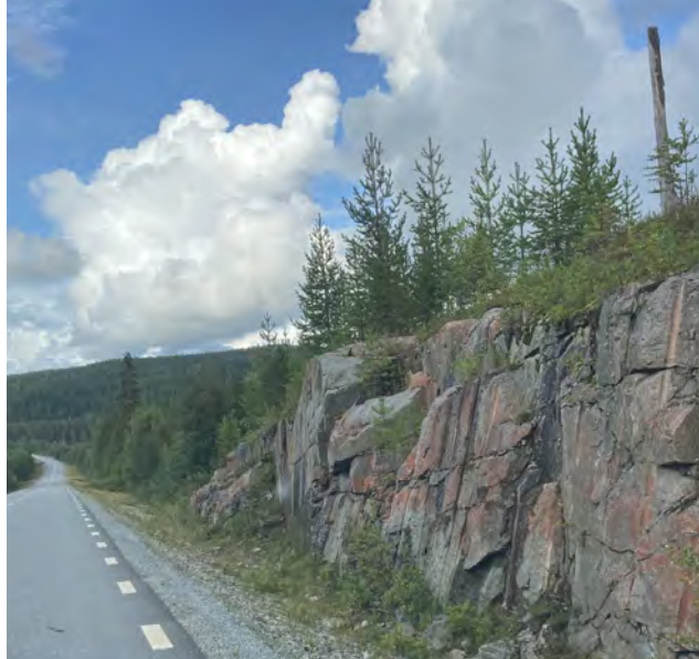
Bild 1. Bergvägg på vägsträcka med hastighetsgräns 100 km/tim (väg 352 någon mil utanför Fredrika) – helt utan skyddsräcke. En bil som kört ner i diketslänten riskerar att få kupén avskalad när den välter och kan leda till ett traumatiskt stopp.
