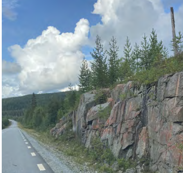
Bild 1. Bergvägg på vägsträcka med hastighetsgräns 100 km/tim (väg 352 någon mil utanför Fredrika) – helt utan skyddsräcke. En bil som kört ner i diketslänten riskerar att få kupén avskalad när den välter och kan leda till ett traumatiskt stopp.
