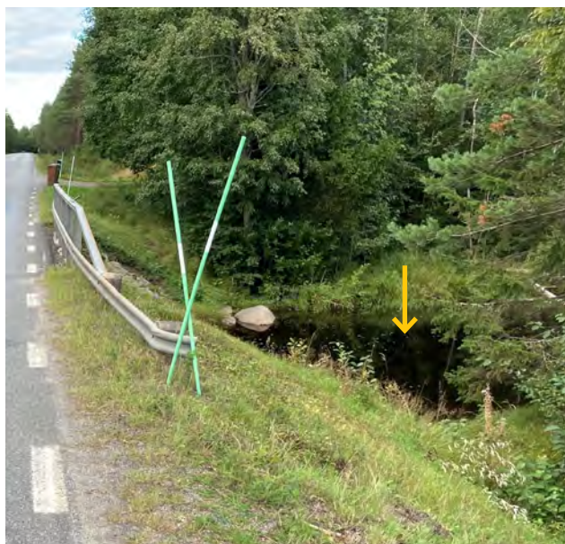
Bild 2. Om man missbedömer passagen finns stor risk för svåra fordon- och personsador, på grund av det korta räcket och/eller att man hamnar i vattnet som räcket skulle skydda för.
