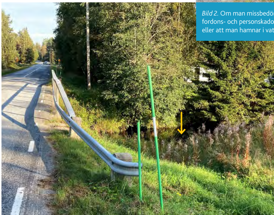
Bild 3. Räckerna över Norrmjölån vid Norrmjölå bygdegård. Räckerna är för korta för att skydda från det som ska undvikas, det vill säga vattendraget. Räckets början har potential att orsaka svåra skador på fordon och åkande. Väg AC 523.
