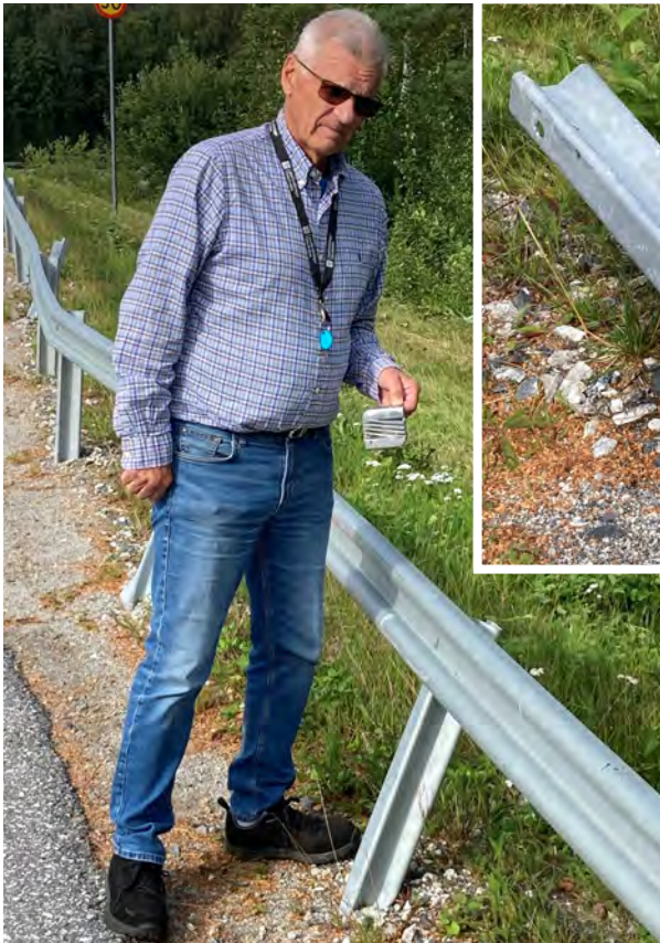
Bild 9. En av författarna hittade omgäende ett Seat-märke vid den mest skadade ståndaren och fann röd färg avskrapad på räcket. Man kan misstänka att en röd Seat varit i kontakt med räcket.
